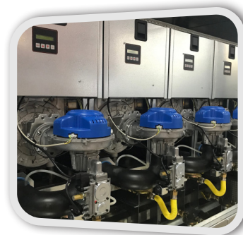
Kondensaciniai katilai kaskadoje
